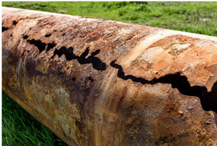
Gambar 3.5: Korosi erosi pada pipa (Nicklin, 2017)
