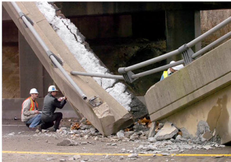
Gambar 4.1: Salah satu Jembatan Roboh karena korosi pada tiang penahannya (Rumah Belajar, 2009)
